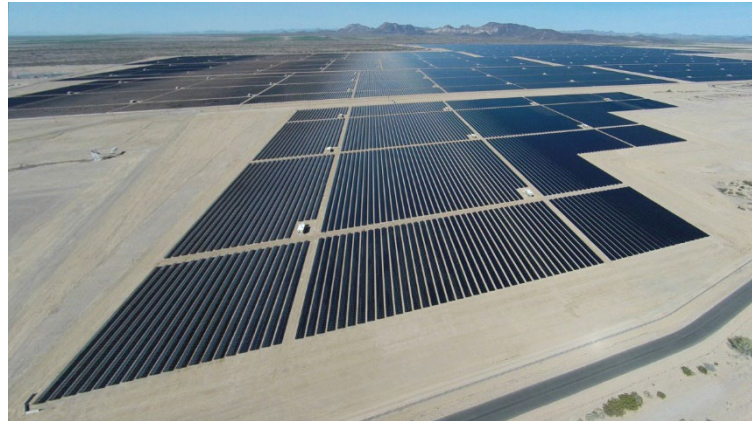
Figura 30. Imagen del Proyecto Solar Agua Caliente cercano a Gila Bend, Arizona. Fotografía: https://clui.org/ludb/site/agua-caliente-solar-project
